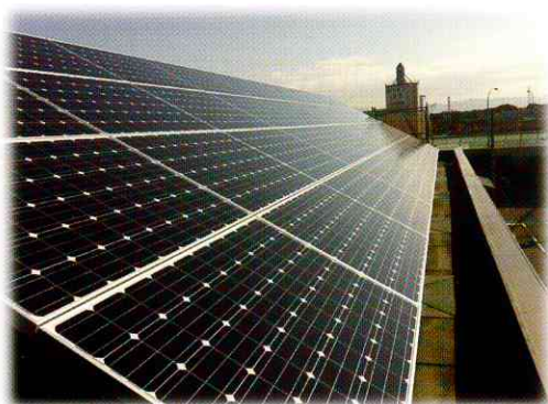
京都本社屋上に設置された太陽光パネル！ Hansol
